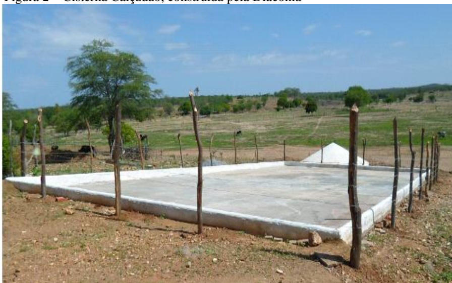
Figura 2 – Cisterna Calçadão, construída pela Diaconia
